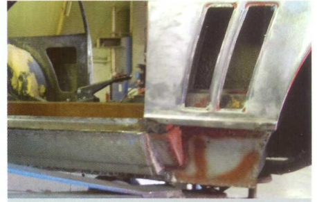
8. De buitendorpel zit er voor het grootste deel tegenaan gelast. Ook hier is geen gebruik gemaakt van het streeplassen maar van het proplassen.
