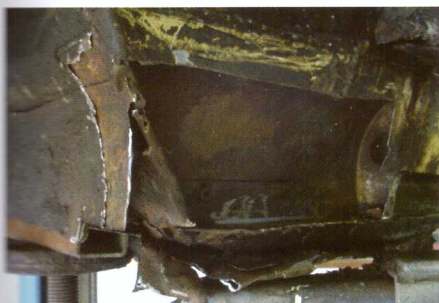
12. Oeioei!!! Als ook de binnendorpel wordt verwijderd, is duidelijk zichtbaar dat er in het verleden doodleuk reparatiestukken tegenaan zijn gelast.
